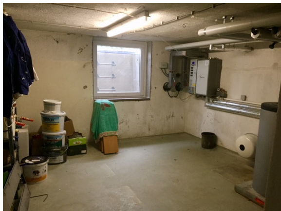
Keller/Heizungsraum mit Notausgang (ostseitig)
