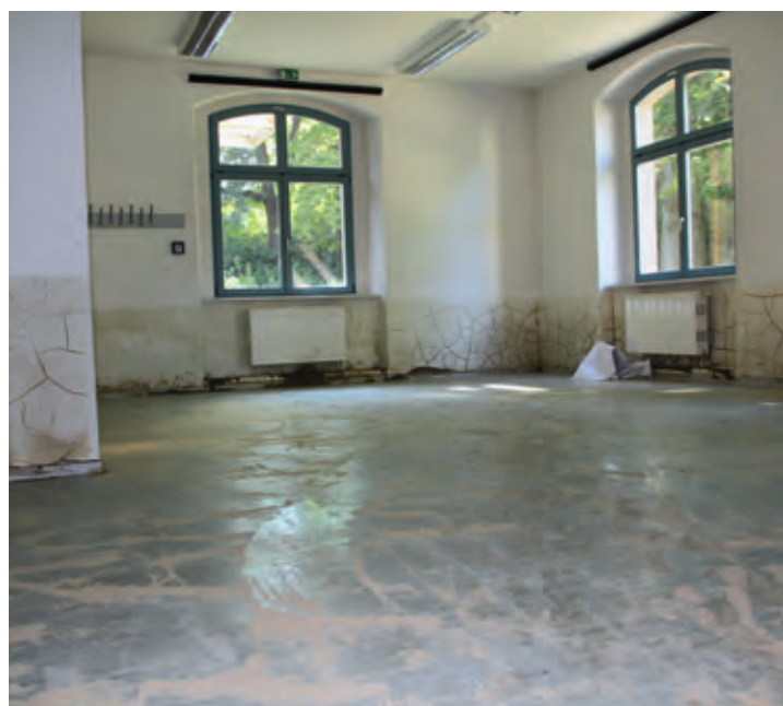
Durchfeuchtete Außenwand nach Überflutung
