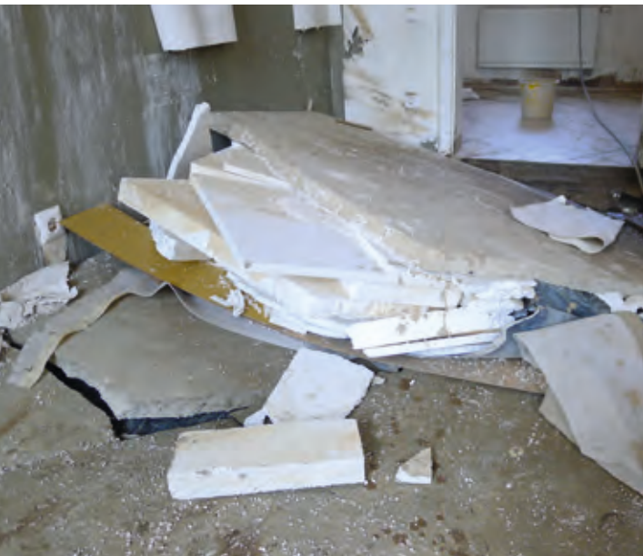
Aufgeschwommener schwimmend verlegter Zementestrich
